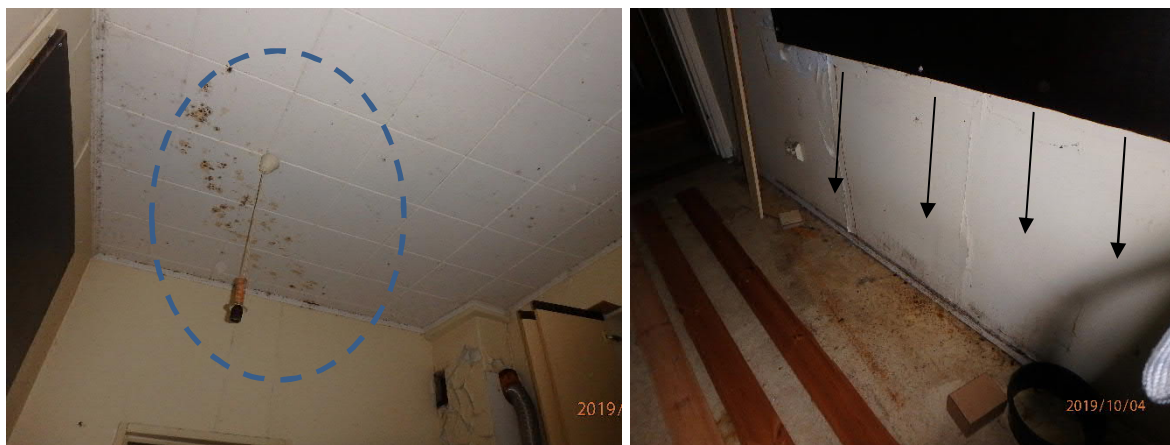
Kuva 3. Rakennuksen sisätilojen näkyvät homevauriot olivat laajentuneet ja rikottujen ikkunoiden kautta oli paikoin vuotanut vettä seinäpintoja pitkin.
