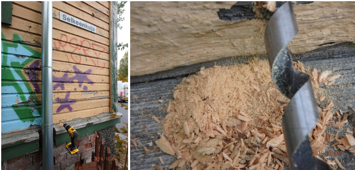
Kuva 5. Länsipäädyn porauksissa havaittiin puuta tuhoaviin hyönteisiin viittaavaa hienojakoista pölyä.
