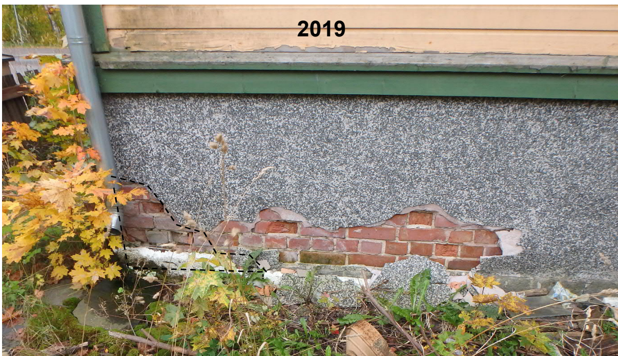
Kuva 1. Perusmuurit ovat poikkeuksellisesti kokonaan tiilirakenteiset. Nurkissa oli havaittavissa etenevää pakkasrapautumista., mutta kokonaisuutena ne olivat rakenteellisesti kohtalaisessa kunnossa ja sortumavaaraa ei ollut.
