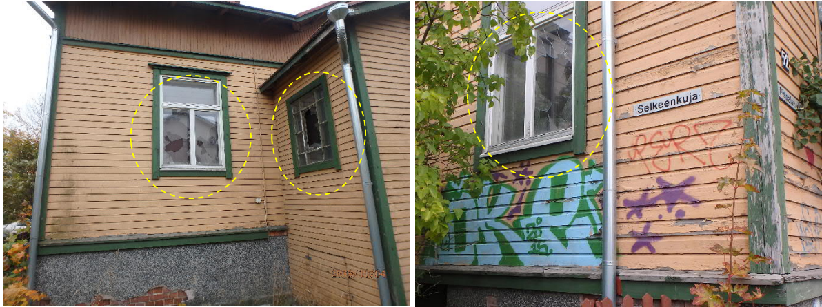
Kuva 8. Rakennuksen ikkunoita oli särjetty vuoden 2015 tutkimuksen jälkeen. Rikkinäiset ikkunat lisäävät rakenteiden kastumista ja nopeuttavat vaurioitumista.
