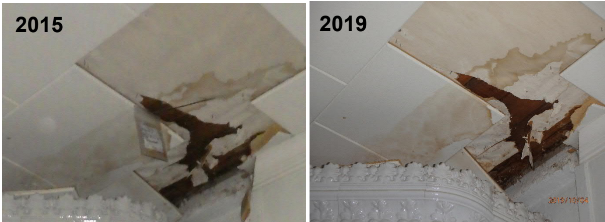
Kuva 6. 1. kerroksen katossa todetut vesivuotojäljet eivät olleet muuttuneet havaittavasti 4 vuoden aikana, joten ainakin osa vaurioita aiheuttaneista kattovuodoista on korjattu aiempien remonttien aikana.
