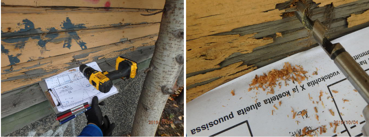
Kuva 4. Eteläsivun porauksissa havaittiin viitteitä alimman hirren lahoamisesta. Porauksessa tuli ulos vain vähän tummaa ja pehmennyttä purua kuivan puulastun sijasta.
