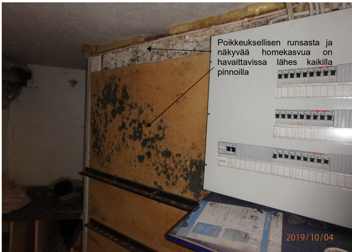
Kuva 2. Kellarikerroksen kaikki pinnat olivat homeessa ja niitä on rikottu polttopuiden saamiseksi. Verrattuna vuoden 2015 havaintoihin, tilanne oli kuitenkin pysynyt lähes ennallaan.
